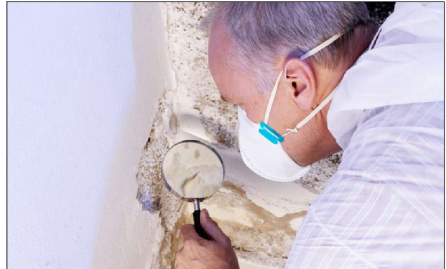
Schimmelbildung durch schlechte Lüftung
